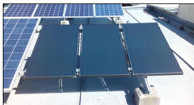
Slika 3 - CIS FN paneli na krovu zgrade FTN
