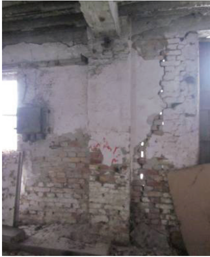
Slika 4. Karakteristična oštećenja na zidanim zidovima
