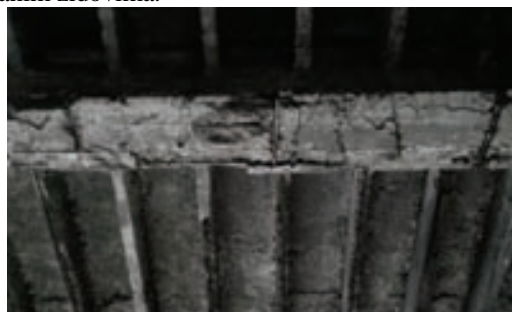
Slika 3. Karakteristični defekti i oštećenja na poprečnim AB gredama i betonskim korubama
