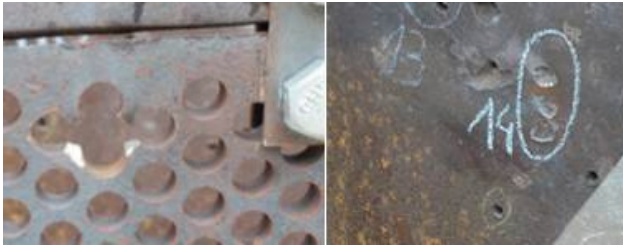
Slika 6. Oštećena površina perforirane i osnovne ploče
