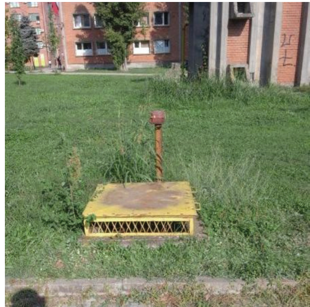
Slika 3. Pomoćni objekti gasovodne mreže
