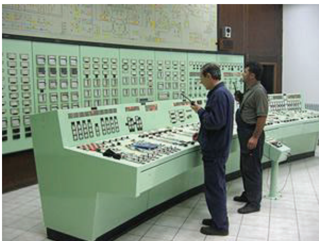
Slika 1. Komanda generatorskog i razvodnog postrojenja
