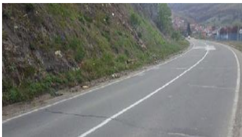
Слика 2: Попречне пукотине на деоници
