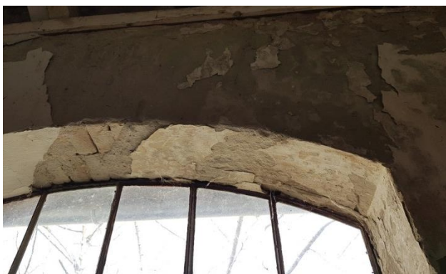
Slika 5. Pukotina u zidanom luku [5]
