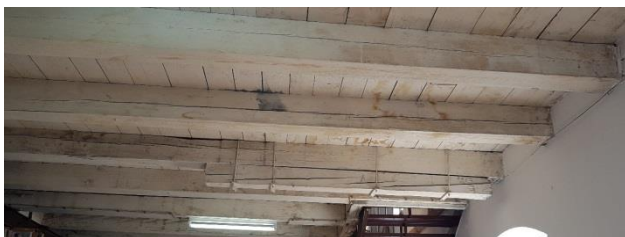
Slika 6. Podužne pukotine na tavanjačama [6]
