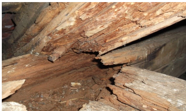
Slika 8. Oštećenje drvenih elemenata krovne konstrukcije
