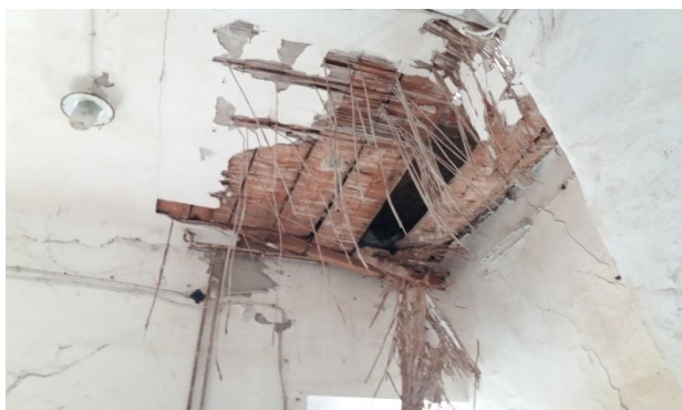
Slika 7. Otkaz drvene međuspratne konstrukcije
