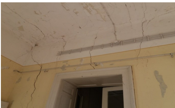
Slika 6. Pukotine iznad vrata na spratu objekta
