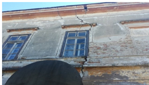
Slika 5. Pukotina na desnoj bočnoj fasadi
