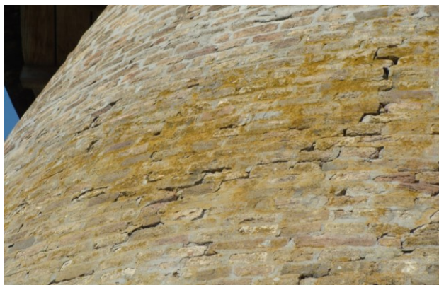
Slika 5: Oštećenja usled vlage od atmosferskih padavina
