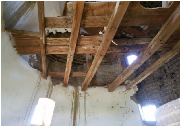
Slika 4: Oštećenja u unutrašnjosti vetrenjače
