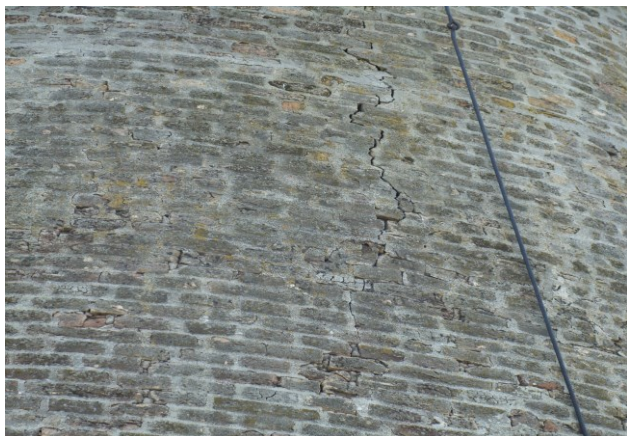
Slika 3: Vertikalna pukotina duž čitavog zida
