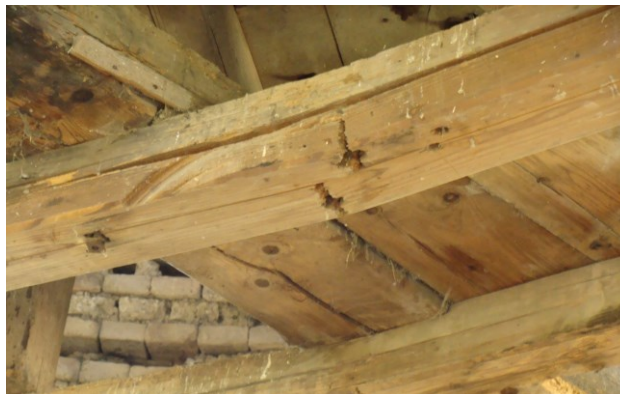
Slika 6: Pukotine na sredini tavanjače
