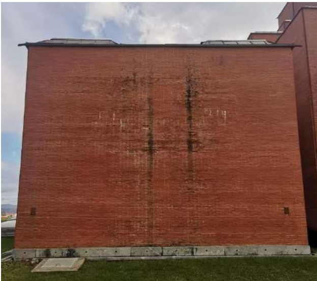
Slika 3. Oštećenja na kulama muzeja
