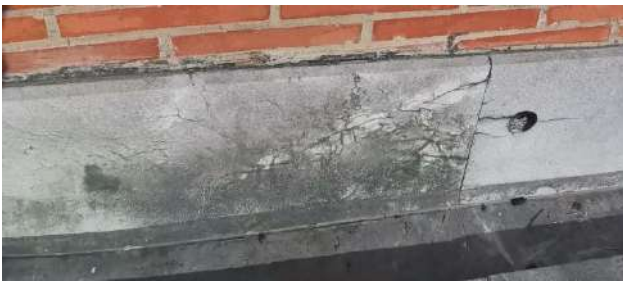
Slika 4. Ispucala površina sokle sa biološkom korozijom
