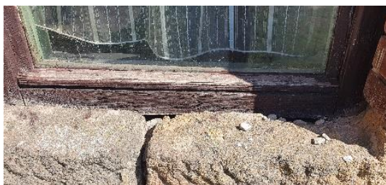
Slika 4. Izgled oštećenog prozora usled neodržavanja
