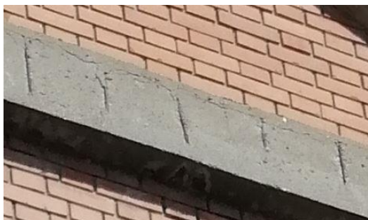
Slika 7 – Vidljiva armatura na AB gredi
