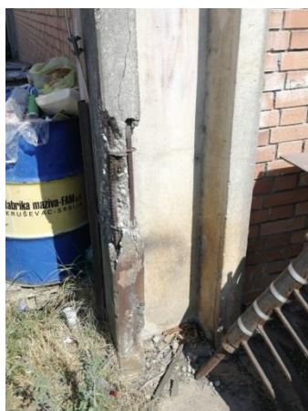
Slika 6 – Vidljiva armatura na mjestu mehaničkog oštećenja
