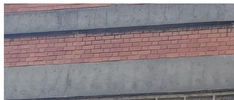
Slika 4 – Mala debljina zaštitnog sloja na AB gredama i AB horizontalnim serklažima
