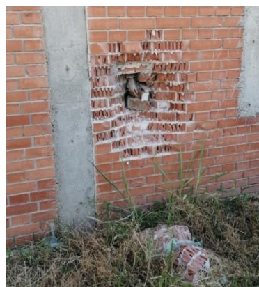
Slika 9 – Oštećenje zidanog zida usled hor. opterećenja
