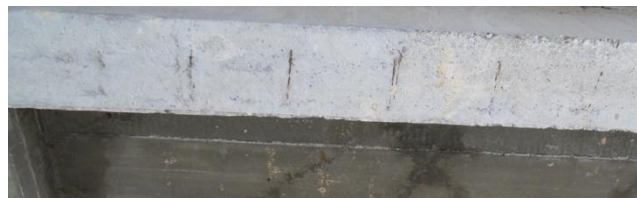
Slika 6. Nedovoljna debljina zaštitnog sloja betona i vidljive uzengije grede
