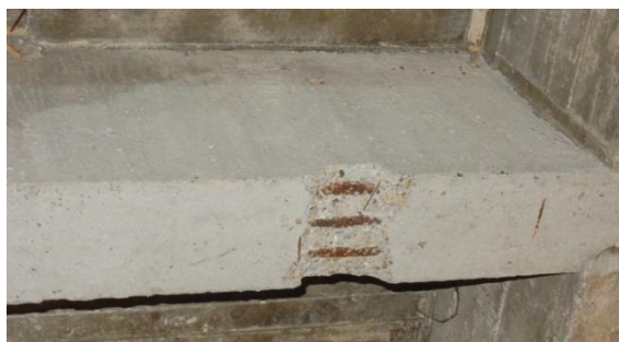
Slika 9. Mehaničko oštećenje rebra i vidljiva armatura
