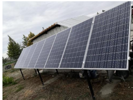
Slika 5: Fotonaponska elektrana na zemlji
