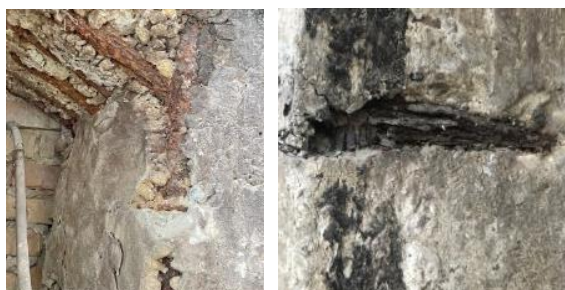
Слика 6 – Изглед стуба С11, недовољна дебљина заштитног слоја, раслојавање, пуцање и отпадање површинског слоја бетона услед јаке корозије арматуре (лево); јака корозија узенгије и главне арматуре (листање челика) изнад прекида бетонирања
