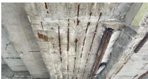
Слика 7 – Недовољна дебљина, пуцање и отпадање заштитног слоја, површинска корозија арматуре на целој доњој површини плоче
