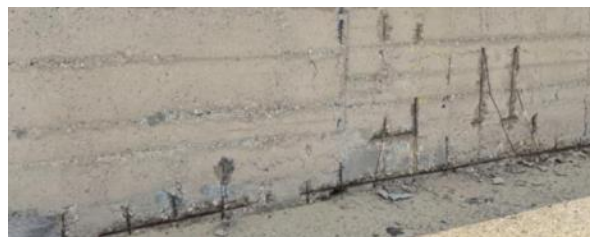
Слика 10 – Раслојавање, пуцање и отпадање заштитног слоја бетона, прекинуте кородирале шипке вертикалне арматуре (параметни зид, сегмент A/5-6)
