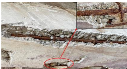
Слика 8 – Неодговарајући састав бетона, саћаст бетон, трошине ивице, јака корозија арматуре са листањем челика (коси део главног носача, сегмент 8/A-C)
