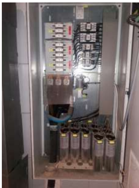
Slika 5 - Ugrađene kondenzatorske baterije i kondenzatorski kontaktori
