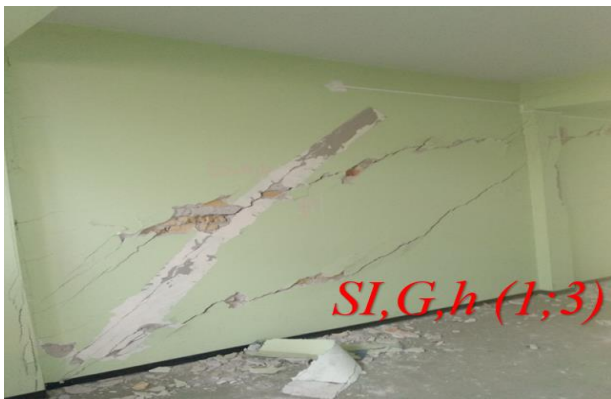
Slika 7. Podužni presek kroz osu G-G, h. Ozbiljno oštećenje zida SI, G, h (1;3) u vidu kosih pukotina
