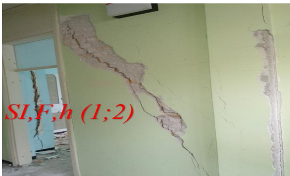
Slika 9. Podužni presek kroz osu F-F, h. Oštećenje zida SI, F, h (1;2), lom zida
