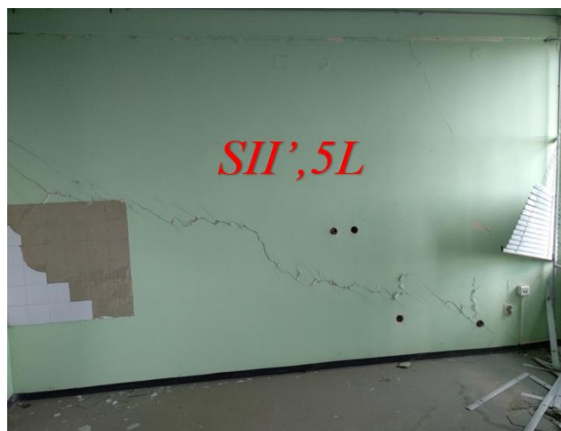
Slika 5. Poprečni presek kroz osu 5'-5'. Oštećenje SII',5L, kose pukotine u zidu
