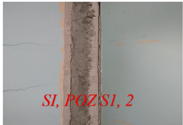
Slika 11. Oštećenje armiranobetonskog stuba na prvom spratu – SI, POZ S1, 2, otpadanje maltera i horizontalne pukotine, zbog prekoračenja čvrstoće betona na zatezanje
