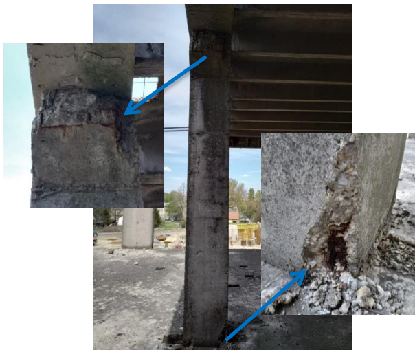
Slika 6 – Korozija horizontalne i vertikalne armature, praćena pucanjem, odvajanjem i otpadanjem zaštitnog sloja betona na čeonj strani kratkog elementa; korozija glavne armature, trošan beton u uglovima donjeg dela stuba
