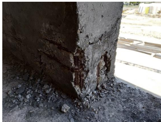
Slika 4 – Betonsko gnezdo i mala debljina zaštitnog sloja betona sa vidljivom horizontalnom i vertikalnom armaturom sa bočne strane (zidno platno)
