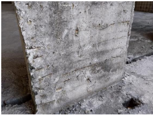
Slika 5 – Ljuskanje i otpadanje betona usled bubrenja korodirale horizontalne armature na unutrašnjoj strani platna (zidno platno)
