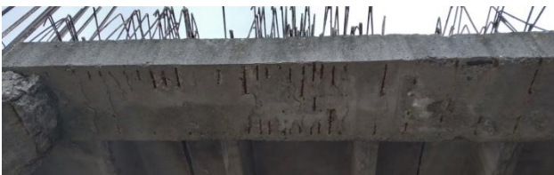
Slika 7 – Opšta korozija uzengija sa bubrenjem, ljuskanjem i otpadanjem zaštitnog sloja betona, lokalno jaka korozija uzengija grede, biološka korozija betona na bočnoj površini grede
