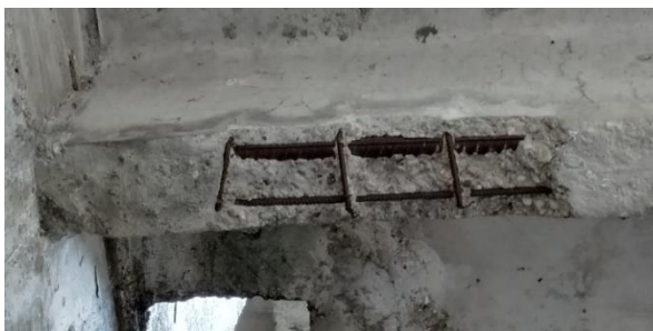
Slika 8 – Otpadanje zaštitnog sloja i korozija armature rebara, tragovi slivanja vode i biološka korozija oko otvora na korubi
