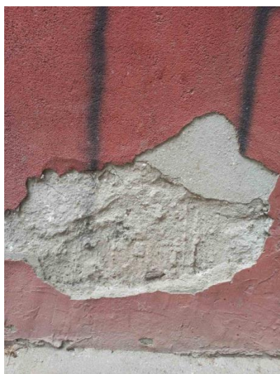
Slika 6. Bubrenje i otpadanje maltera i završnog sloja fasade
