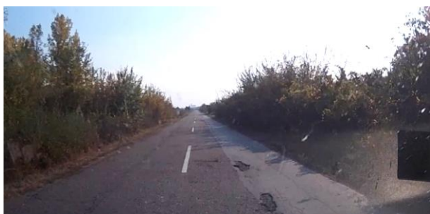
Slika 5: Predmetna deonica sa oštećenjima
