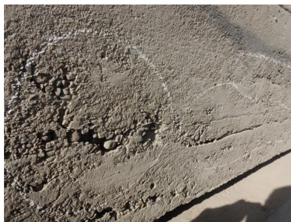
Slika 8. Veće betonsko gnijezdo na zidnom platnu
