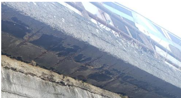
Slika 13. Korozija armature, nedovoljna debljina zaštitnog sloja betona - glavni nosač i konzolni ispust
