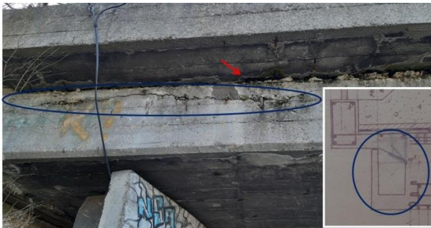
Slika 12. Pukotina na mestu nepovezanih slojeva betona u zidu kanala za odvodnjavanje atmosferskih voda u sklopu glavnog nosača
