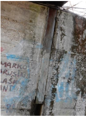
Slika 9. Oštećena olučna instalacija, slivanje vode, biološko rastinje
