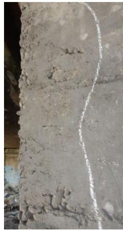
Slika 10. Betonsko gnijezdo na AB platnu
