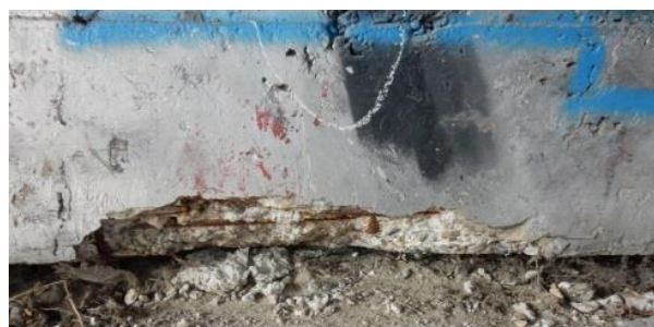
Slika 7. Otpadanje površinskog sloja betona, vidljiva korozija armature stuba u donjim dijelovima zidnog platna
