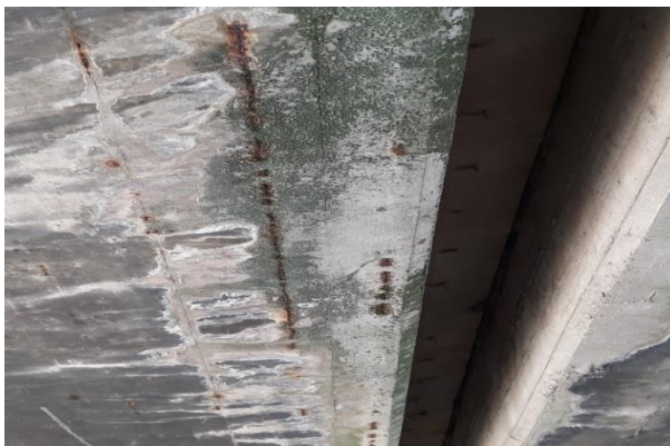
Slika 11. Slivanje vode na spojnici, površinska korozija armature, hemijska i biološka korozija betona, glavni nosač
