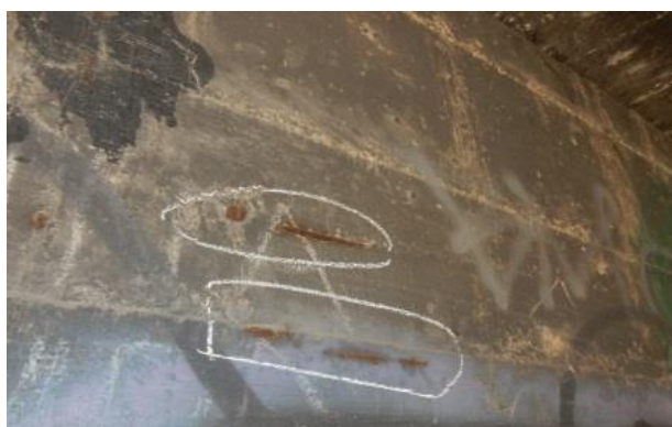
Slika 6. Mali zaštitni sloj betona, vidljiva korozija armature, zidno platno
