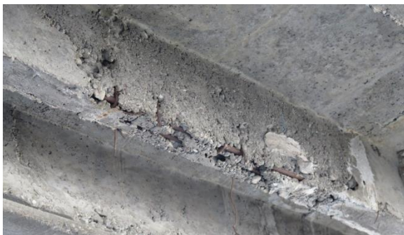
Slika 8 – Betonsko gnijezdo cijelim obimom rebra, šupljikav beton, vidljiva korozija armature
