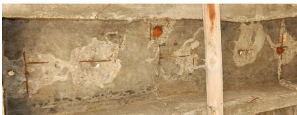
Slika 9 – Rupe sa okolnim otpadanjem betona, jaka korozija armature u zonama rupa
