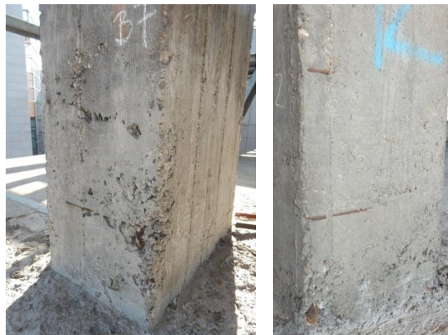
Slika 4 – Betonsko gnijezdo u donjem dijelu stuba i vidljiva korodirala armatura (lijevo); mala debljina zaštitnog sloja betona i vidljiva armatura sa površinskom korozijom (desno)
