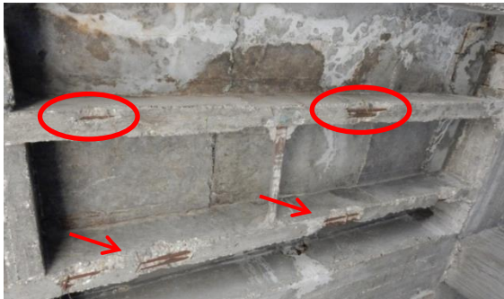
Slika 7 – Odvaljeni donji delovi rebara, ogoljena armatura zahvaćena korozijom, podužna pukotina cijelom dužinom ploče tavanice sa izluživanjem
