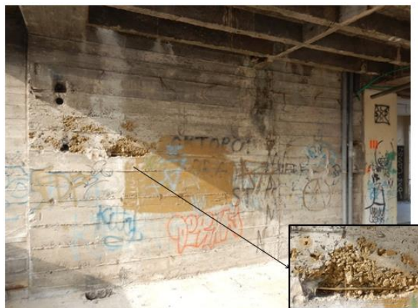
Slika 5 – Opšti izgled zidnog platna u osi 11 na III spratu i detalj: rupa u zidu, veće betonsko gnijezdo, površinska korozija armature
