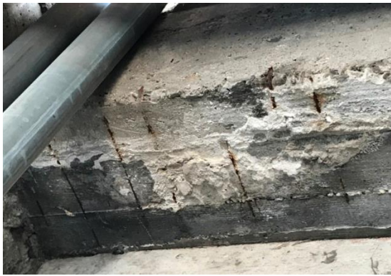
Slika 6 – Nedovoljna debljina zaštitnog sloja betona, vidljive korodirale uzengije na donjoj površini poprečne grede, nataložene naslage na donjoj površini
