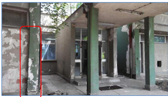
Слика 4. Пукотине и деформација стуба у оси 7
