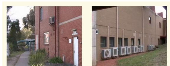
Slika 5. Primer dobre prakse prilikom postavljanja klima uređaja [4]
