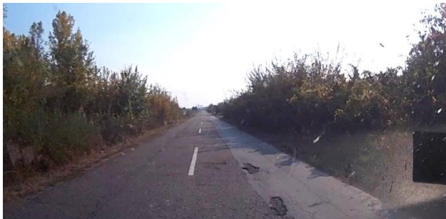
Slika 5: Predmetna deonica sa oštećenjima
