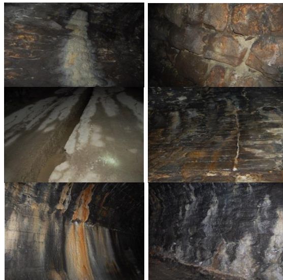
Slika 7: Karakteristična oštećenja kamene obloge i podnožnog svoda
