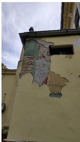
Slika 5. Otpadanje maltera sa fasade
