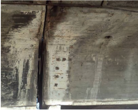
Slika 3. Oštećenja kod oslonca zone 1
