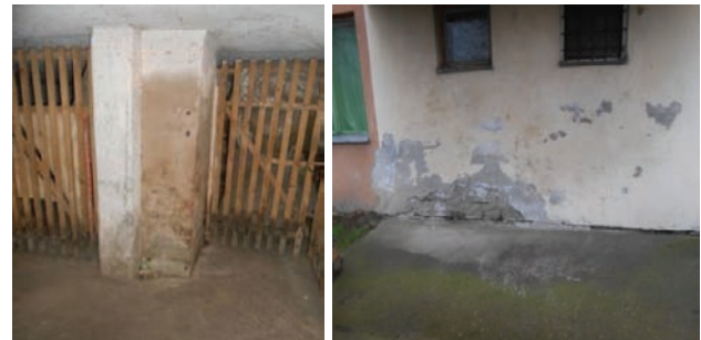
Slika 4. Levo: Mrlje od vlage, mali zaštitni sloj betona, otpadanje površinskog sloja maltera.
