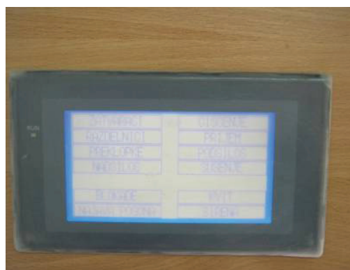
Slika 4. Operatorski panel na silosu "AVEKS"
