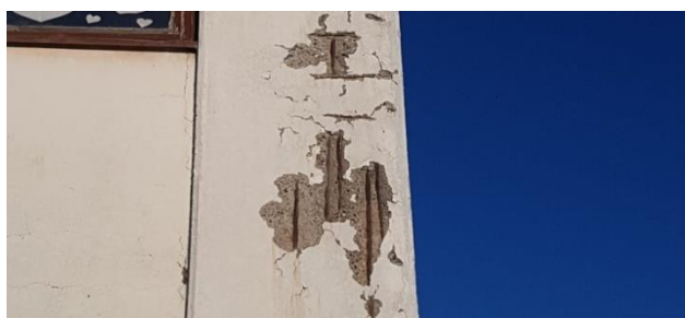
Slika 2 - Korozija armature; Pucanje, odvajanje i otpadanje zaštitnog sloja betona usled korozije armature
