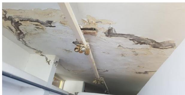
Slika 3 - Ljuskanje i otpadanje završnog dekorativnog premaza i maltera sa plafona usled procurivanja vode
