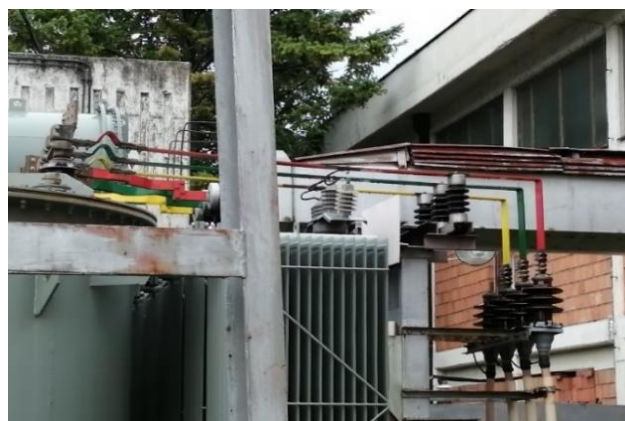
Slika 1. Izgled šinskog razvoda koji je na sekundarnoj strani energetskeg transformatora.
