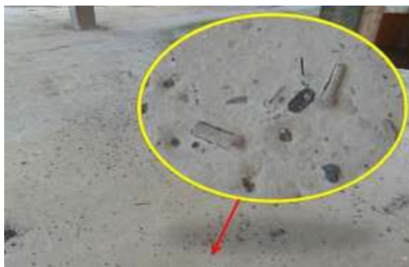
Slika 8. Rupičasta površina betona posledica korištenja zaprljanog agregata
