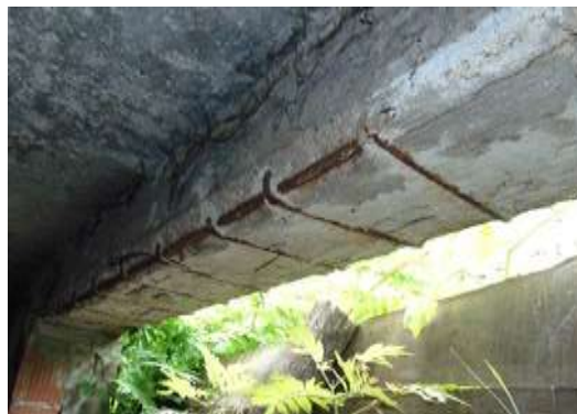
Slika 6. Korozija armature i hemijska korozija betona na gredi prizemlja
