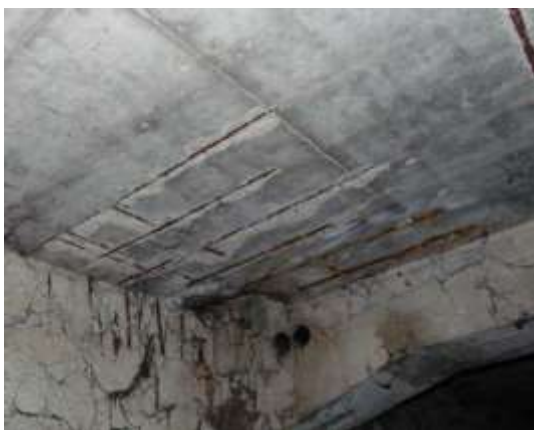
Slika 7. Korozija armature donje površine ploče iznad podruma
