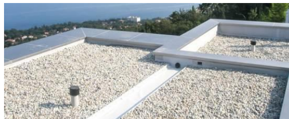
Slika 2. Neprohodna krovna terasa
