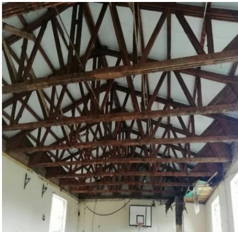
Slika 6. Dotrajala drvena krovna konstrukcija i ostaci spušenog plafona
