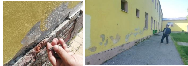
Slika 4. a) Trošan materijal, krunjenje elemenata opeke uslijed dejstva vlage, mraza, soli, oštećena i dotrajala hidroizolacija, b) Otpadanje, guljenje i ljušpanje maltera i boje sa fasadnih zidova uslijed djelovanja kapilarne vlage
