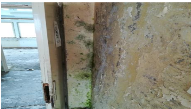
Slika 4. Oštećenja na unutrašnjoj strani zida
